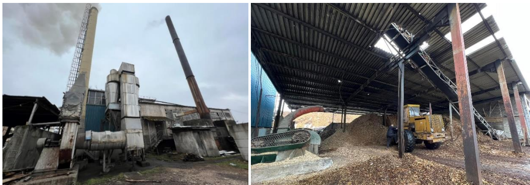
Slika 1: Postojeća toplana i natkriveno otvoreno skladište biomase sa sječicom i transportnom trakom za biomasu
